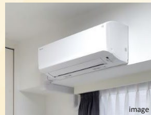
空気清浄機能・換気機能 付きエアコンの設置 19,000円/台~
