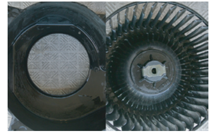
浴室換気扇 清掃後
